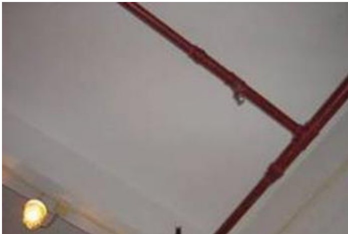
Water sprinkler Alarm 水喷淋报警
