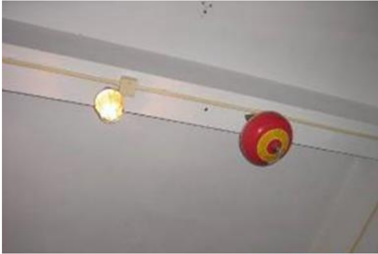
Fire Alarm 火警警报器
